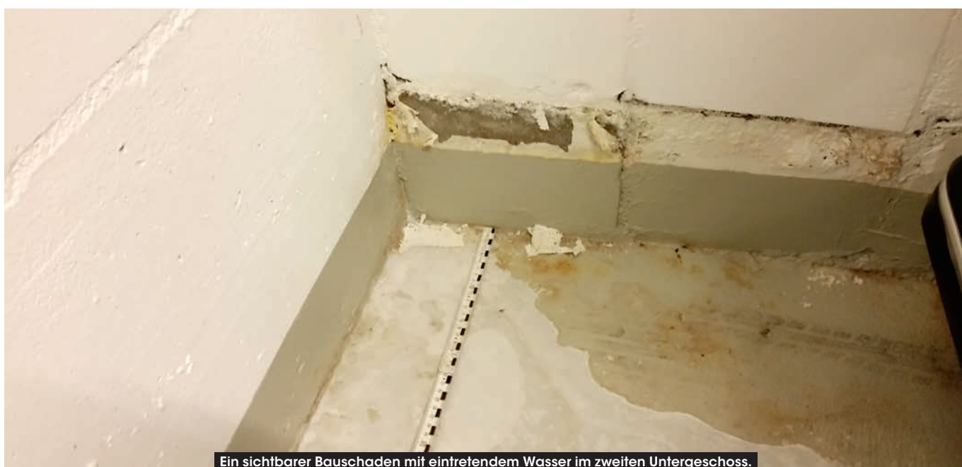
Ein sichtbarer Bauschaden mit eintretendem Wasser im zweiten Untergeschoss.
