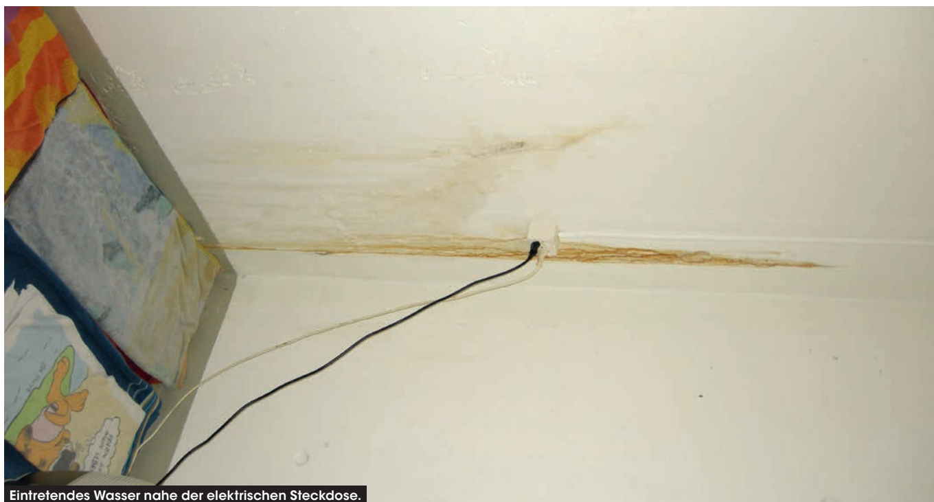
Eintretendes Wasser nahe der elektrischen Steckdose.
